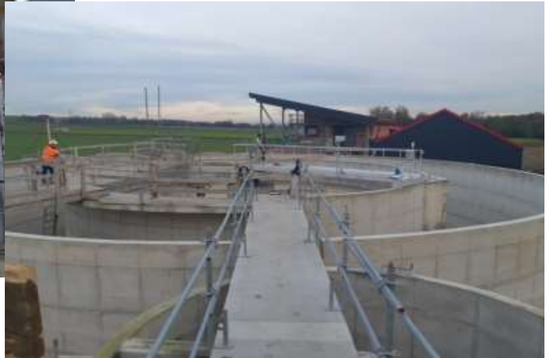
Bassin d'aération et clarificateur
